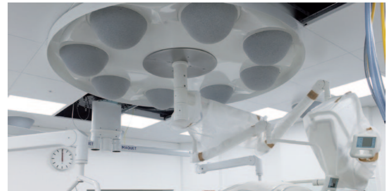
Einbau des Opragon Systems in der Clinica Luganese Moncucco
